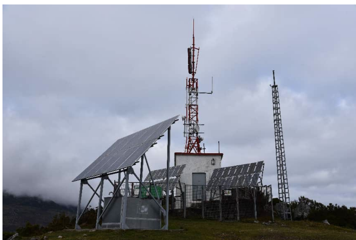
Instalaciones de telecomunicaciones de Cueto la Jaya
