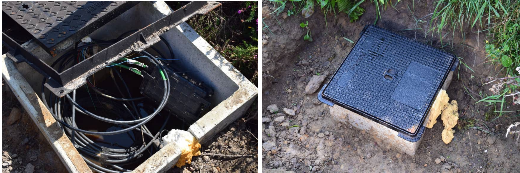
Ejemplo de arqueta objeto de inspección con el cableado
